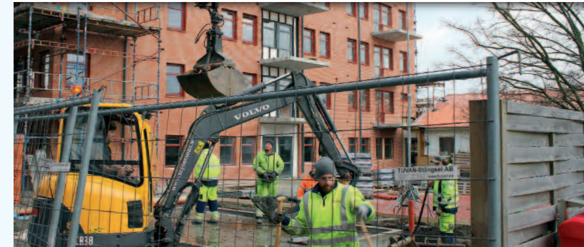
I slutet av november monterades byggnadsställningarna på Furen 2 ned. I januari är en visningslägenhet klar och första inflyttning är planerad till den 1 maj.
